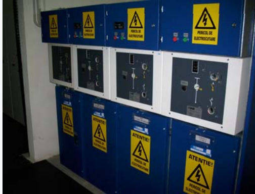
Celule Medie Tensiune 10 kV
